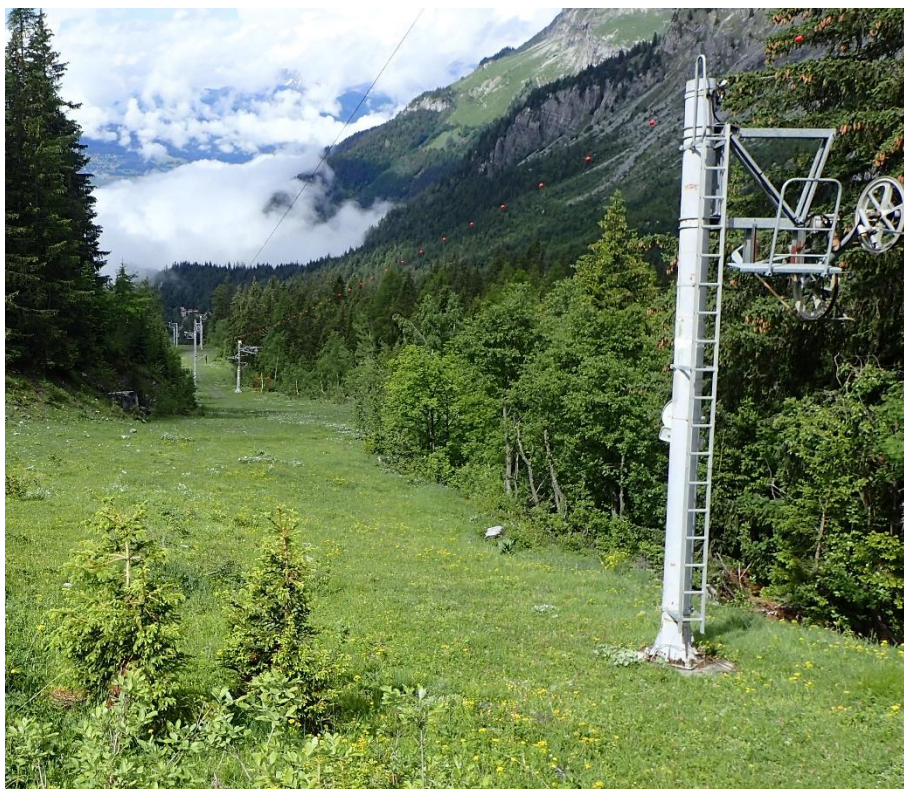
Exemple de massif béton où le travail de purge à réaliser reste limité
